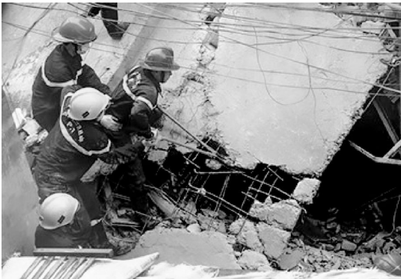
Cán bộ, chiến sĩ Cảnh sát Phòng cháy, chữa cháy và cứu nạn, cứu hộ Công an thành phố Hà Nội cứu người trong vụ sập nhà trên phố Trần Hưng Đạo, thành phố Hà Nội, ngày 22/9/2018
